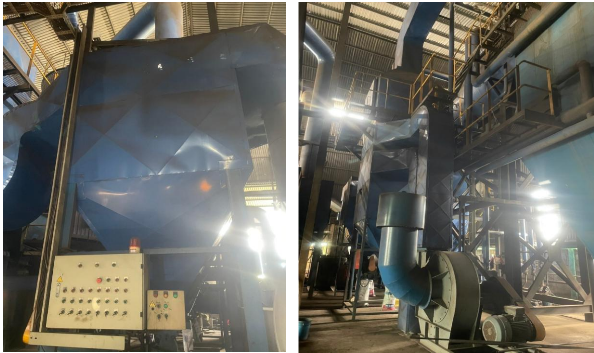
Hình 3.12 HTXLKT lò hơi 12 tấn hơi/giờ
